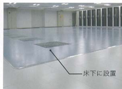
データセンター (大阪府)
